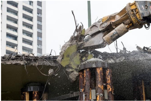
Bild 1: Kraftvoll: Ein 70-Tonnen-Abrissbagger "knabbert" sich Stück für Stück durch Stahl und Beton.
