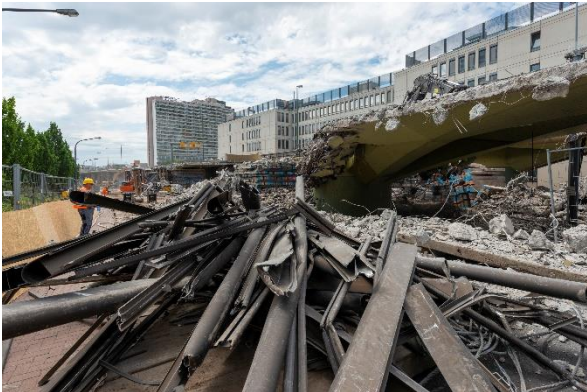
Bild 7: Sortiert: Vor dem Abtransport wird der Schutt noch getrennt. Er wird in verschiedenen Depots untergebracht, kann größtenteils recycelt werden.
