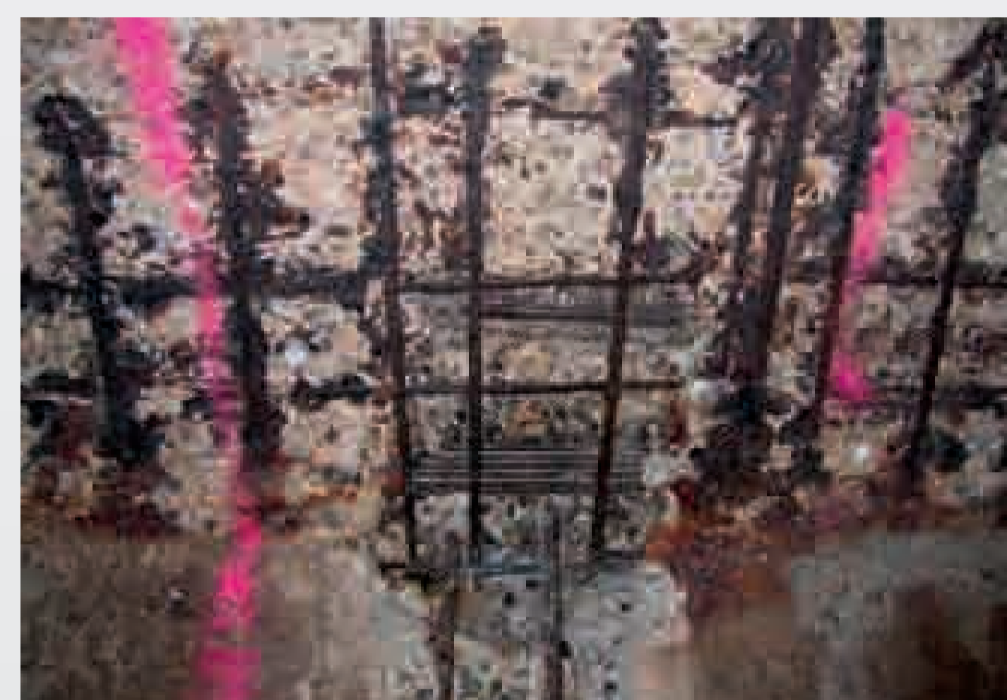
→ Frei gelegte Bewehrungsstäbe der Brückenkonstruktion.
