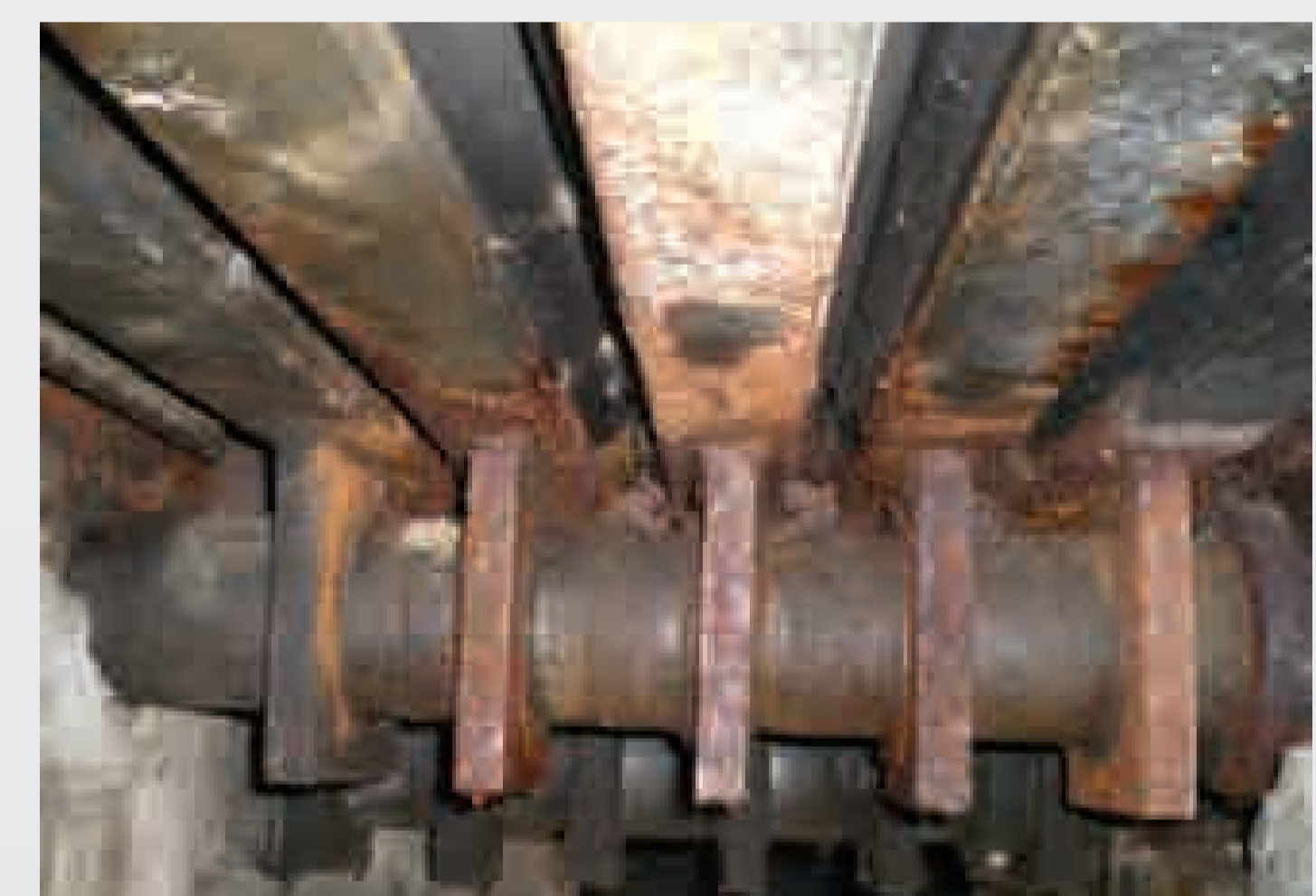
→ Stark korrodierte Übergangskonstruktion.
