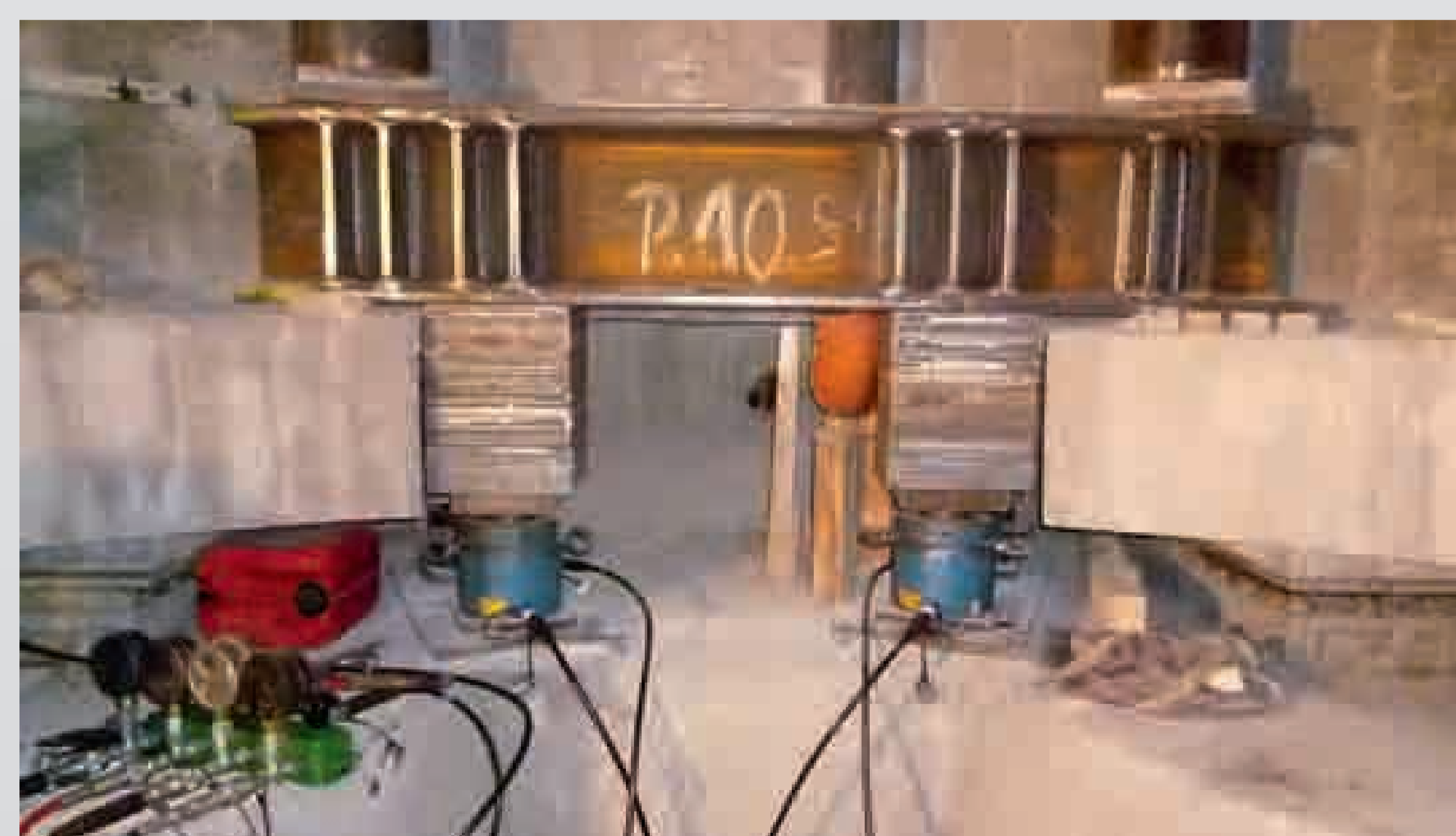
→ Im Zeitraum 2015 bis 2016 wurden als erste Sanierungsmaßnahme die Lager der Pilzhochstraße ausgetauscht. Die Arbeiten wurden bei laufendem geschwindigkeitsreduzierten Verkehr durchgeführt. © Christopher Bevermann „INGENIEURGRUPPE BAUEN“
