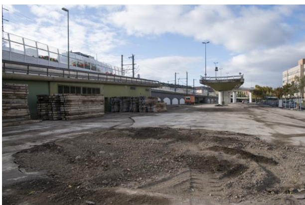
Bild 2: Nach Abschluss der Aufräumarbeiten werden die Aushebungen der Pilzsockel verfüllt und zeitnah mit einer Asphaltdecke versiegelt.
