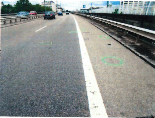
167-0_FB BELAG MIT HOHLSTELLEN
