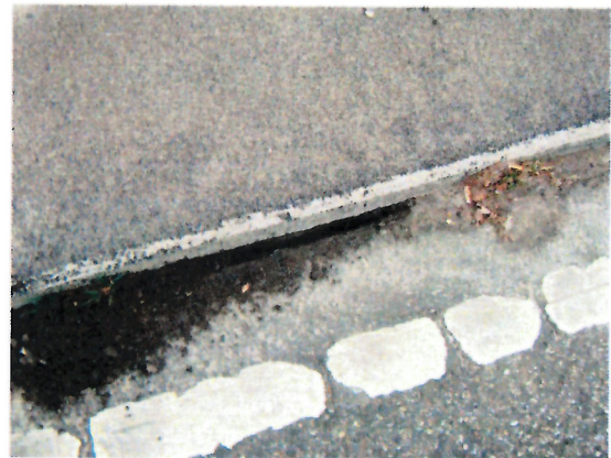
BW 167 UEB_FB_FUG_FÜLLUNG RANDFUGE FEHLT
