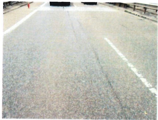
167-0_FB BELAG IST HÄUFIG GERISSEN
