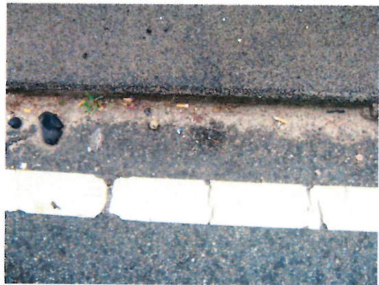
BW 167 UEB_FB_BLASENBILDUNG AM FAHRBAHNRAND
