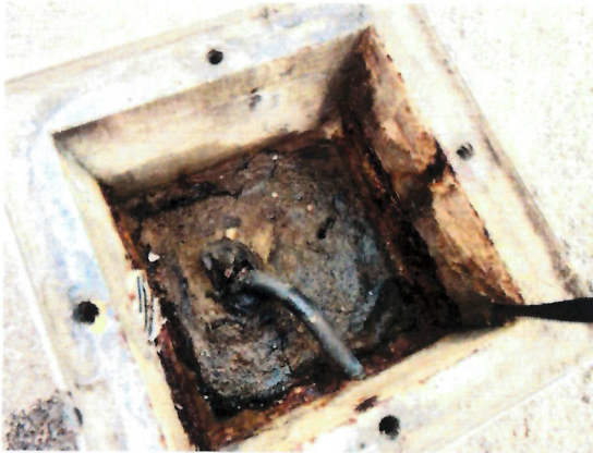
167-0_MK KABELZUGSCHACHT IST DURCHFEUCHTET
