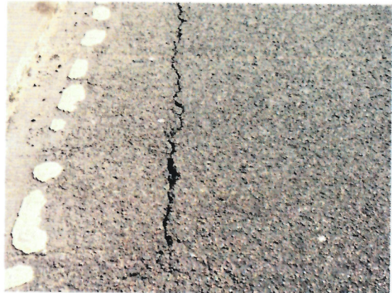
167-0_FB BELAG IST GERISSEN UND AUSGEBROCHEN
