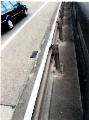
BW_167_UEB_AK_ABPLATZUNGEN UND HOHLSTELLEN BESCHICHTUNG
