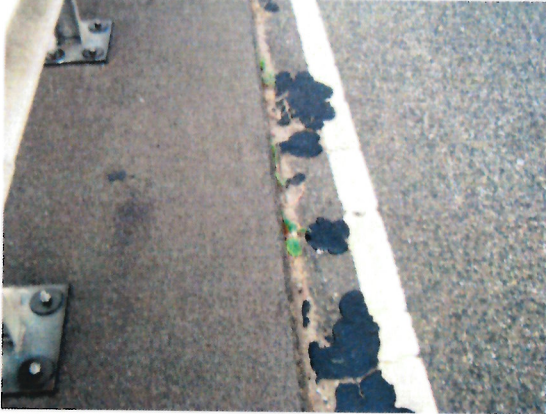
BW 167 UEB_FB_FUG_FÜLLUNG RANDFUGE HERAUSGEQUOLLEN
