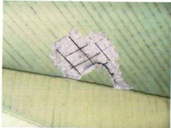
BW_167_UEB_US_ABPLATZUNG MIT HOHL LIEGENDEM BETONTEIL
